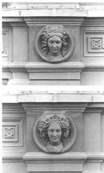
Predigergasse 10: Rekonstruierte und neu gebauene Kopfmedaillons.
