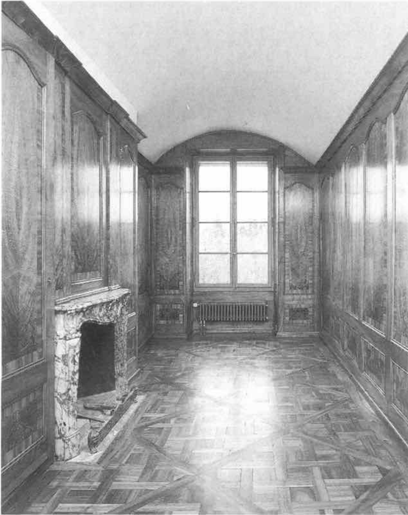
Junkerngasse 39: Kabinettzimmer im zweiten Obergeschoss auf der Aareseite mit spätbarocker Nussbaumtäferung und -parkett sowie Cheminée.
