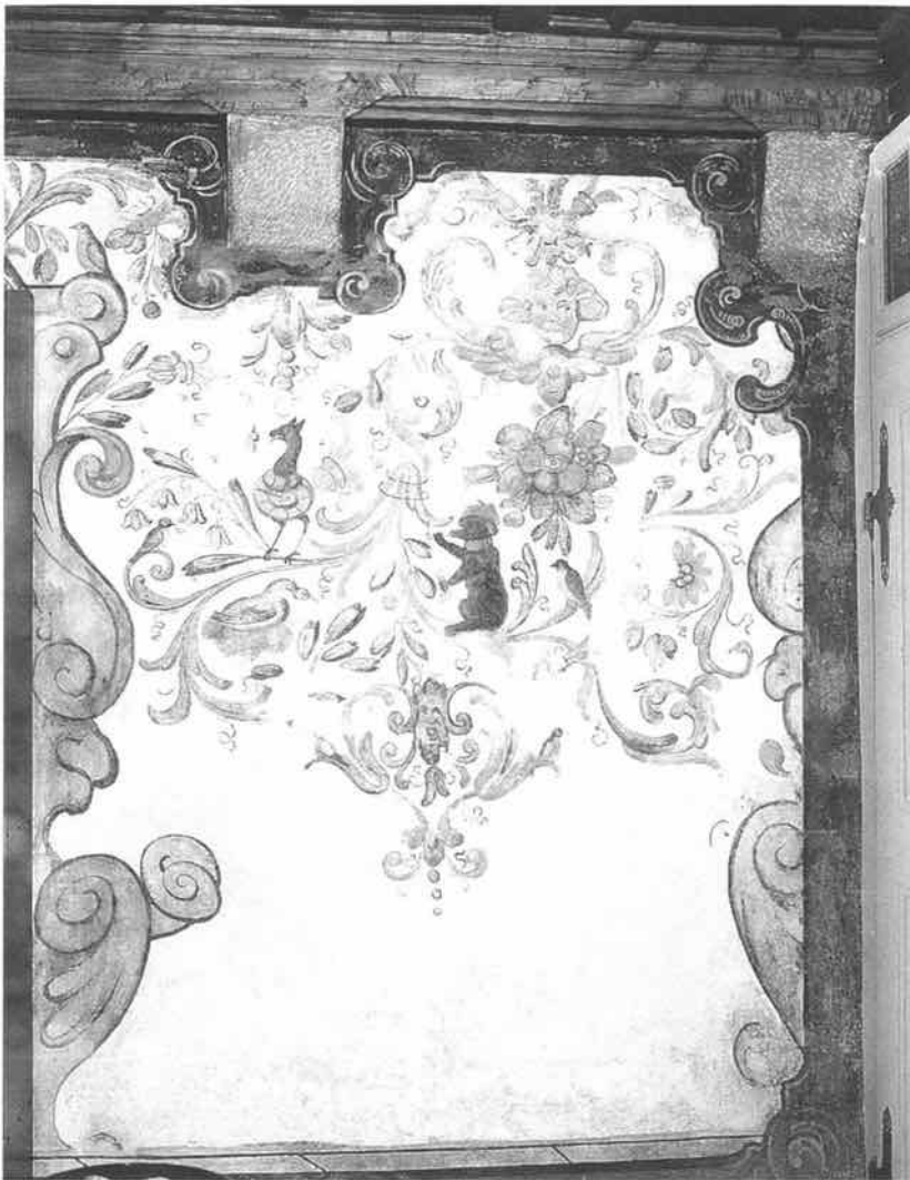
Gerechtigkeitsgasse 71: Lebhafte, bunte Wand- malerei des Manierismus im Gassenzimmer des ersten Obergeschosses.
