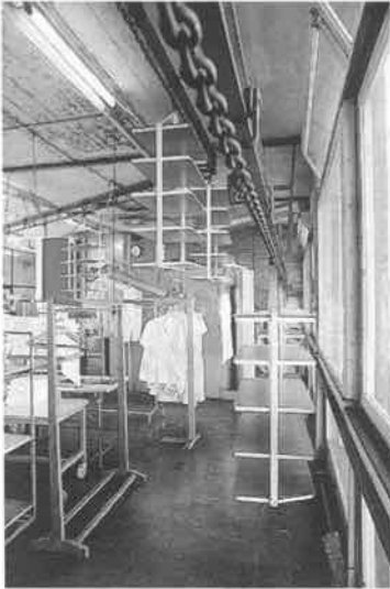
Weihergasse 11: Transportanlage, im Neubau 1955 eingebaut. Belegstück im Rahmen des Umbaus im Gebäude erhalten.
