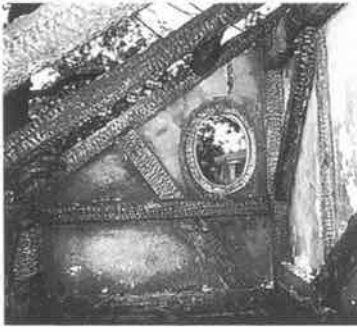
Alpeneggstrasse 10: Ausgebranntes Dachgeschoss mit statisch tragfähig gebliebener Holzkonstruktion.
